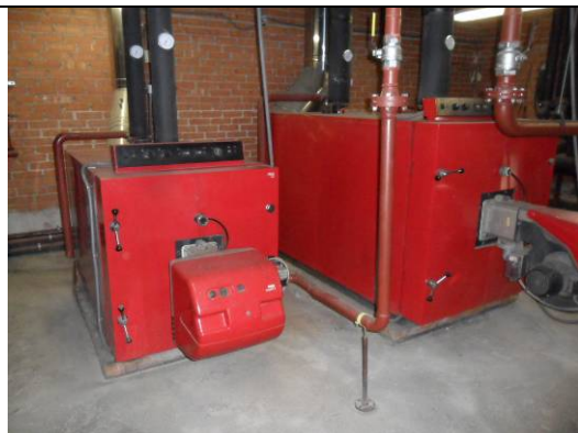
Sala de calderas
