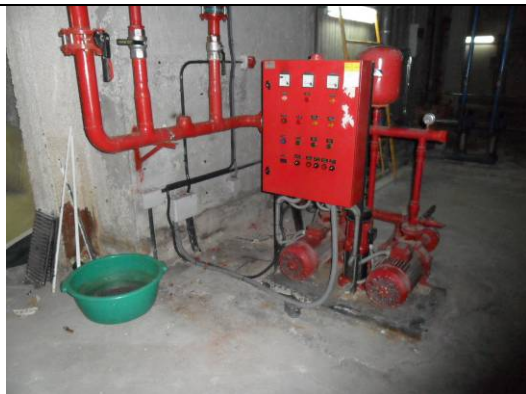
Protección contra incendios
